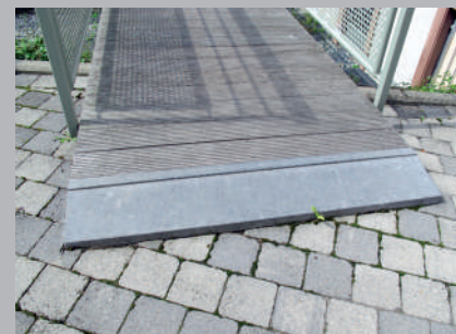
✗ Ressaut au départ de la voie d'accès
