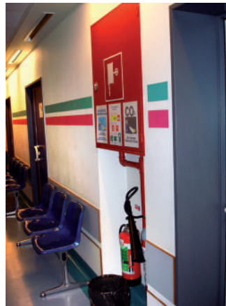
✓ Extincteur placé dans une niche
