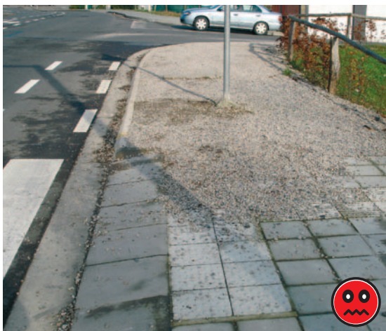
Matériau de revêtement piéton inadapté
