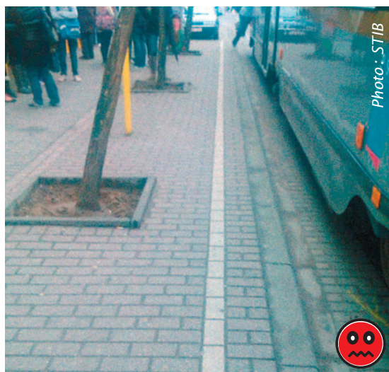
Zone de protection délimitée par des bordures surélevées constituant un obstacle pour l'utilisateur
