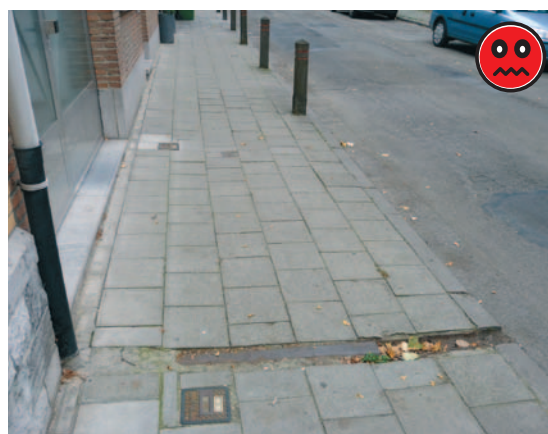
Évacuation d'eau inadaptée
