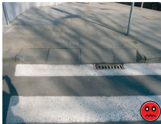
Jonction chaussée-cheminement piéton inaccessible (pentes non conformes et avaloir présent dans la traversée)
