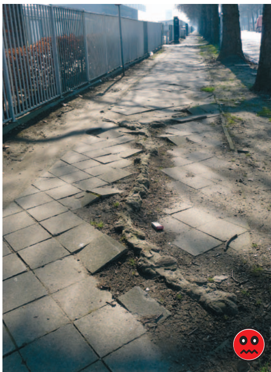
Trottoir dégradé par un système racinaire aérien
