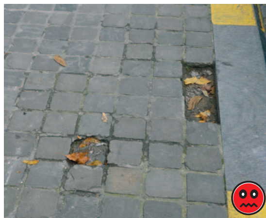
Revêtement détérioré consécutivement à une perte de matériau
