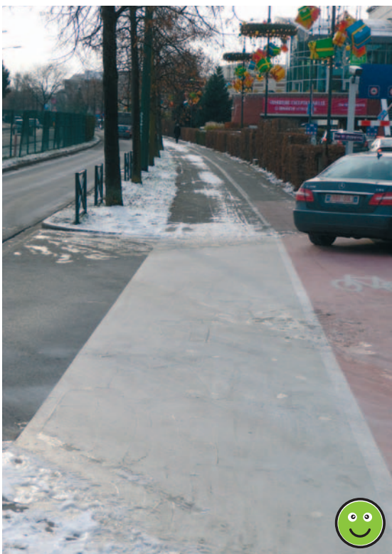
Zone de sollicitation importante où le revêtement a été modifié
